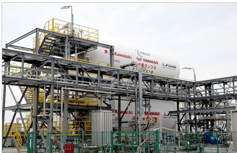
図 2 液化水素燃料供給設備外観
